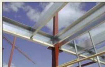
Figur: Ett lätt stålbjälklag byggs upp med bärande C- eller Z-profilerade balkar. I dagsläget byggs lätta stålbjälklag med spännvidder upp till ca 4 meter. För att bygga lätta bjälklag med längre spännvidder behöver vi lära oss mer om lätta bjälklags dynamiska egenskaper och hur människan uppfattar dem.
