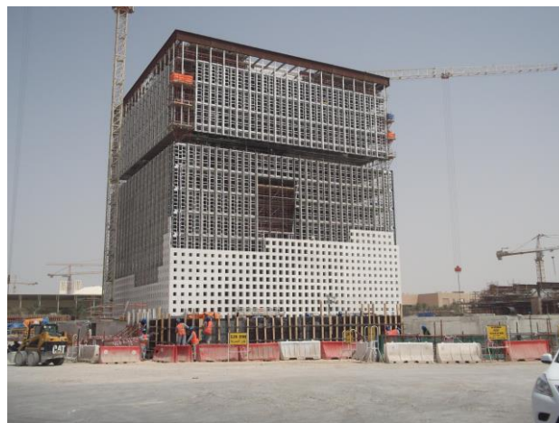
Montagearbete med grova svetsade fyrkantrör och profiler från Outokumpu i Degerfors pågår av Qatar Foundations huvudkontor i Doha, Qatar.
